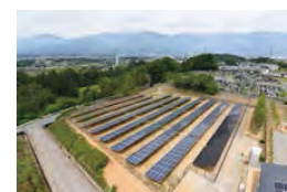
リユース品を使用した発電所
